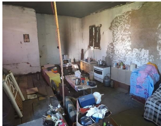
Figura 83: Condição da área da cozinha do galpão.
