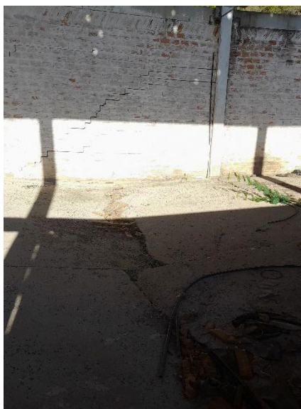
Figura 55: Estrutura em condições não adequadas, necessidade de reparação.
